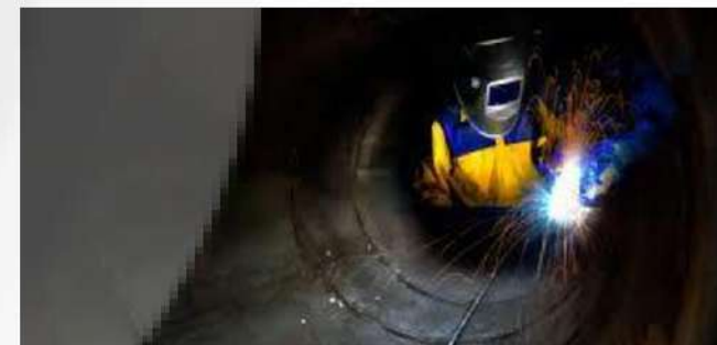
Sujeto a acumulación de contaminantes.
