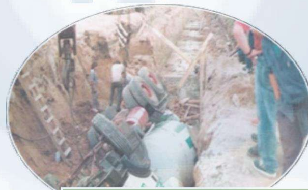
Vuelco de maquinaria
